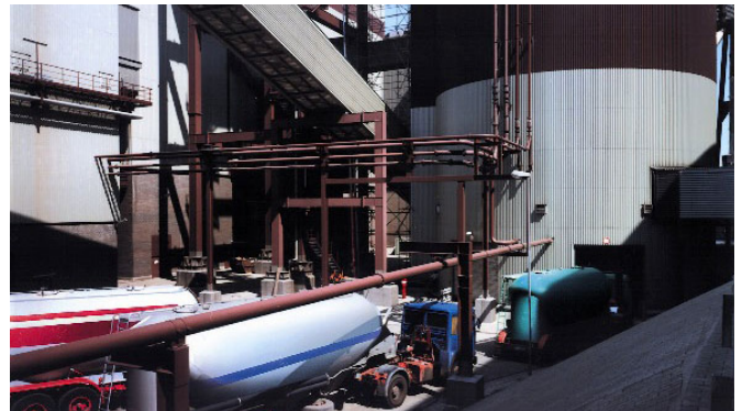
Siloanlage für Steinkohlenflugasche (SFA)
